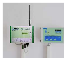
Einbau im Pegelhaus mit Powerbox
